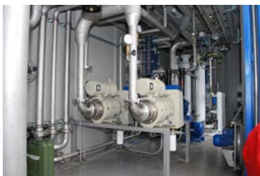
Épuration du biogaz.
